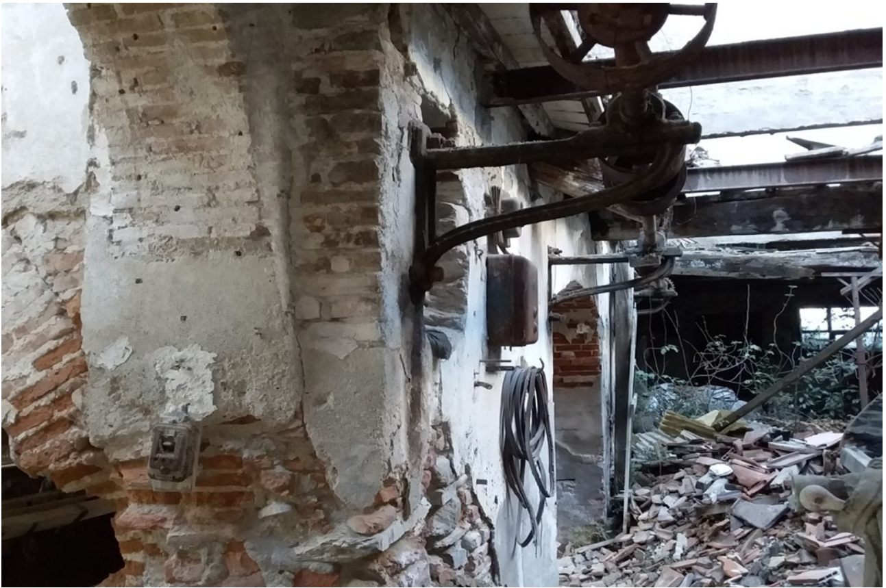
Foto 11- Interni: parte collassata. Ripresa verso ovest
