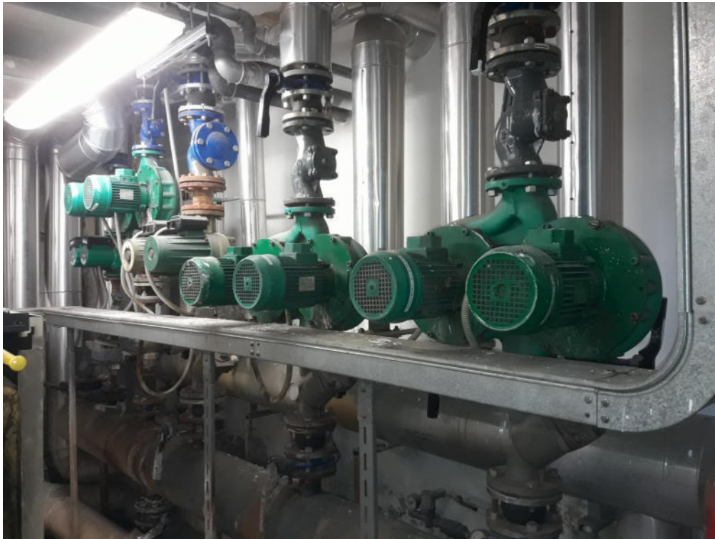
Foto 3 – Pompe di sollevamento
