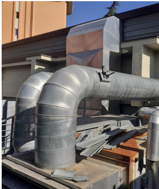
Foto 10 – Canali di distribuzione
