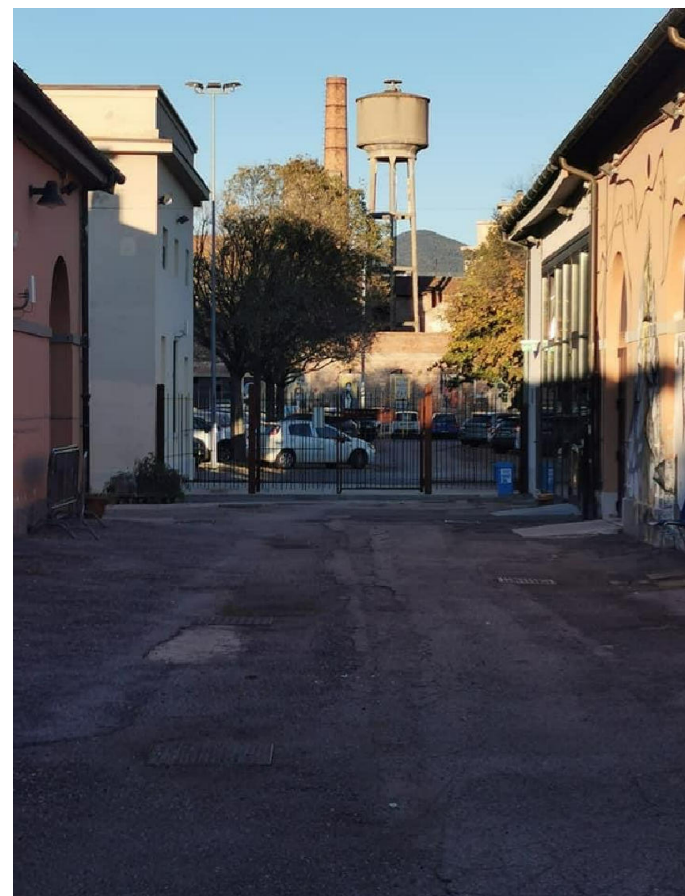
Stato attuale del manto in asfalto dell'ingresso Sala Eventi e bar-ristorante
