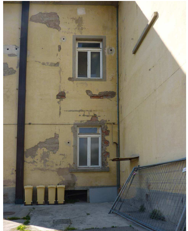
Fig. 4 - particolare intonaco prospetto nord
