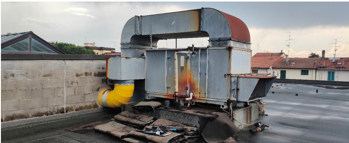
Figura 19 - UTA esistente in copertura oggetto di sostituzione
