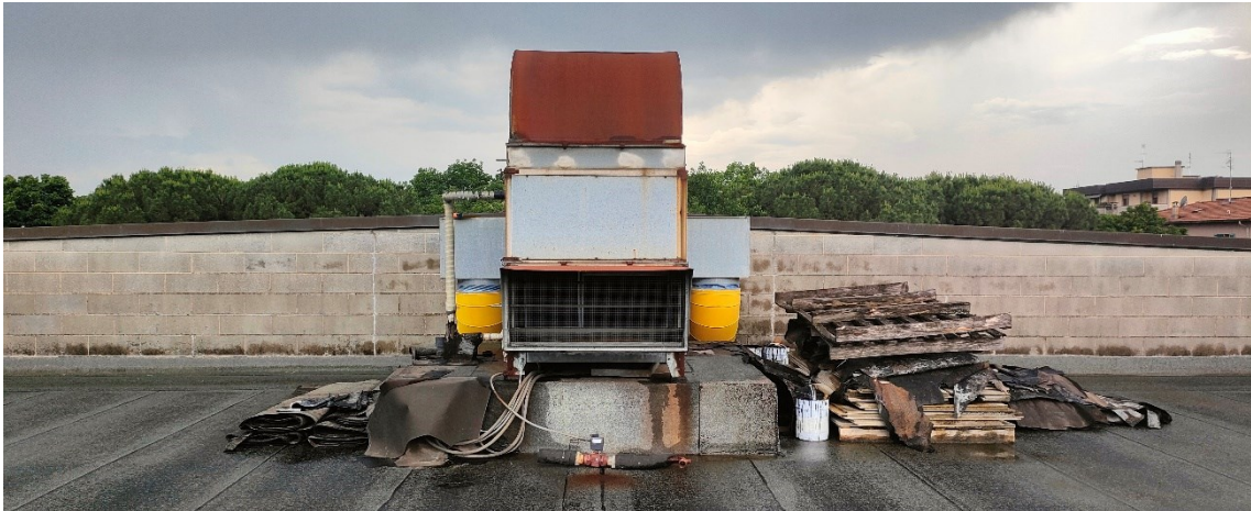
Figura 18 - UTA esistente in copertura oggetto di sostituzione
