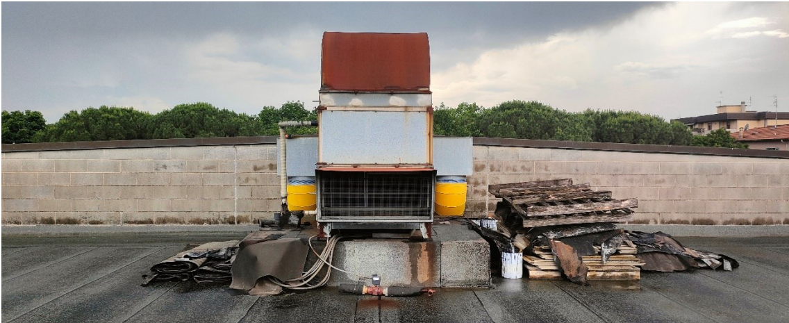
Figura 18 - UTA esistente in copertura oggetto di sostituzione
