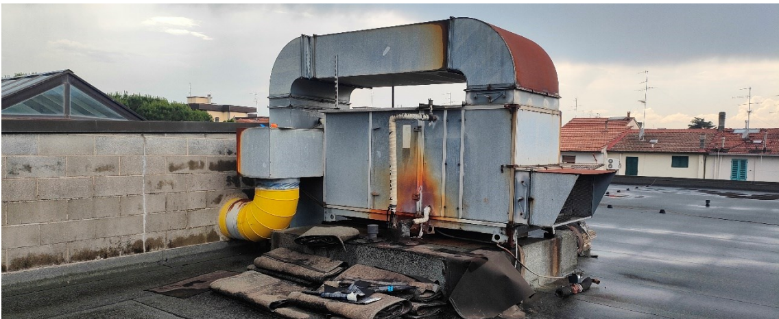
Figura 19 - UTA esistente in copertura oggetto di sostituzione
