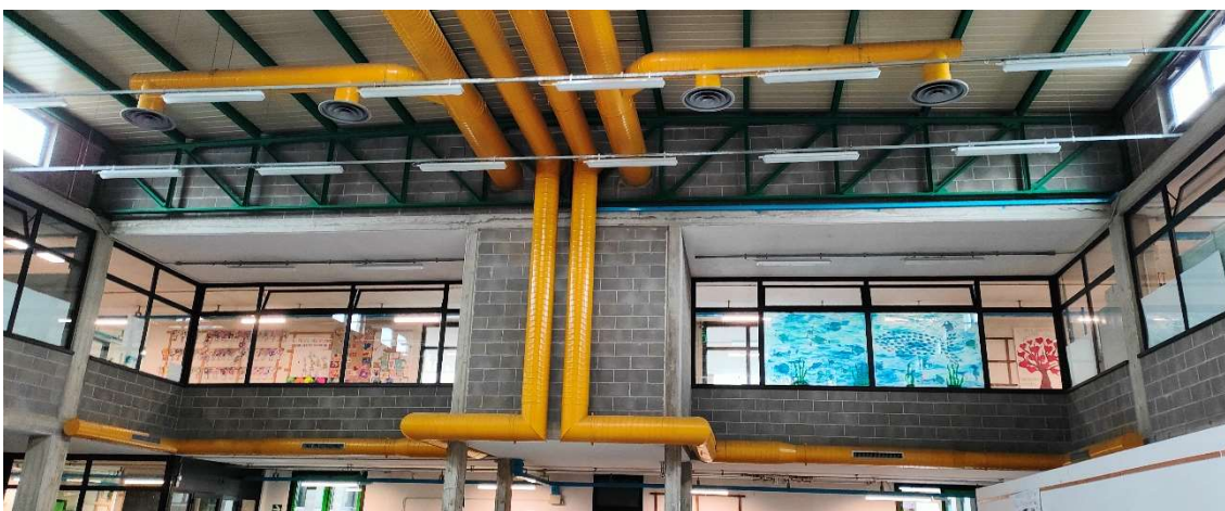
Principali canalizzazioni di mandata e ripresa dell'aria climatizzata di ventilazione
