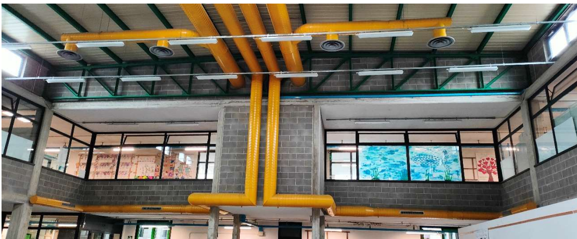
Principali canalizzazioni di mandata e ripresa dell'aria climatizzata di ventilazione
