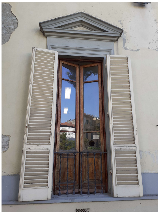
Foto da n. 15 a n. 22 – Tipologie infissi esterni (compreso lucernario vano scala)
