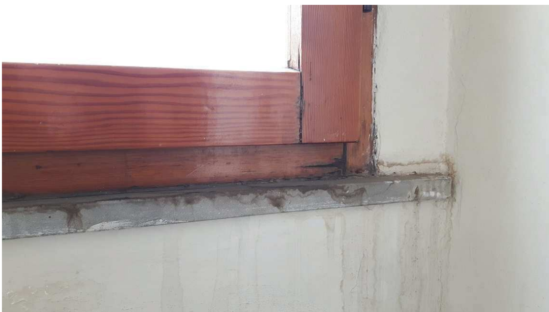
infisso P1.08 - stato attuale – battuta inferiore con evidenti infiltrazioni
