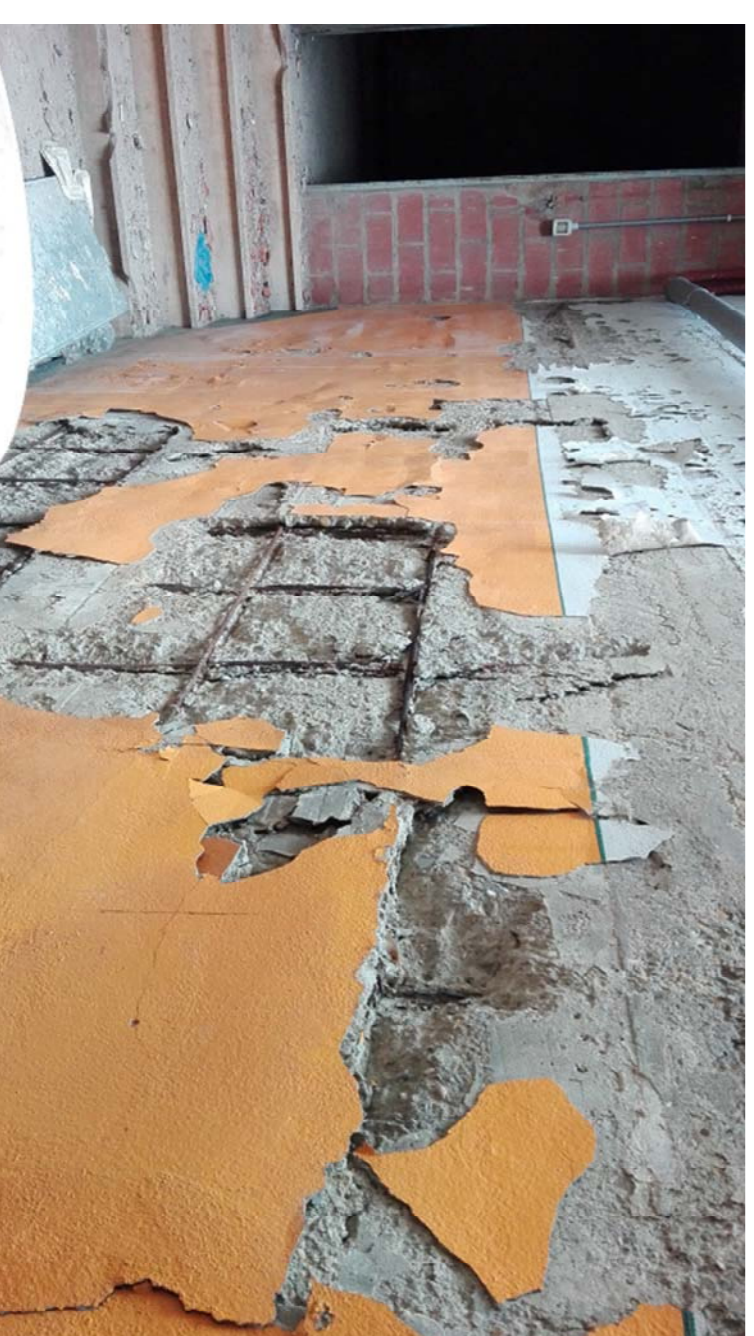
Particolare porzione muratura soggetta a risanamento
