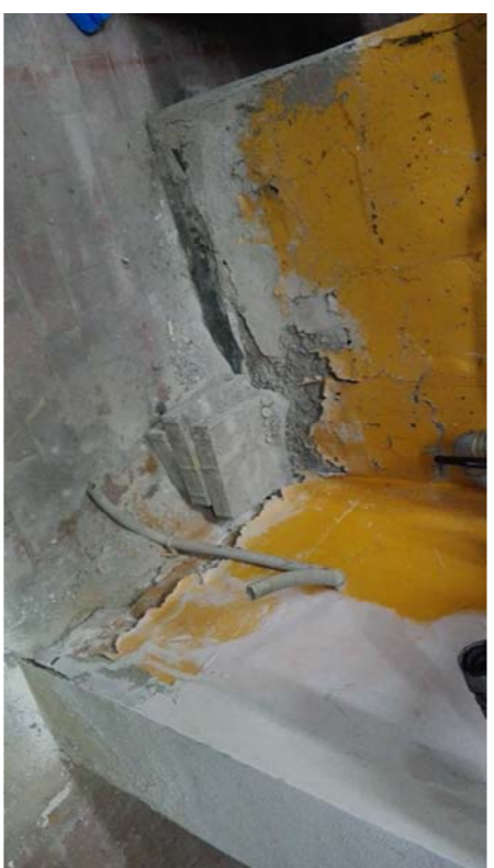
Particolare porzione muratura soggetta a risanamento
