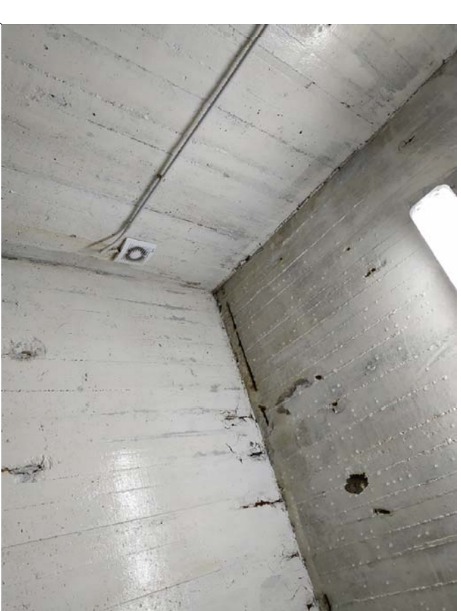
Particolare locale ripostiglio attuale ventola di aspirazione
