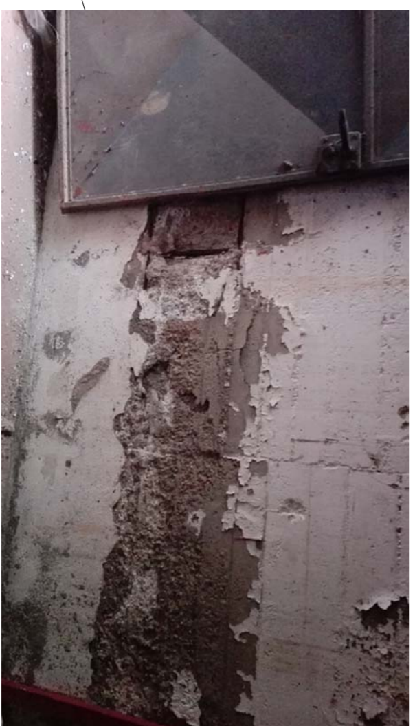
Particolare porzione muratura soggetta a risanamento
