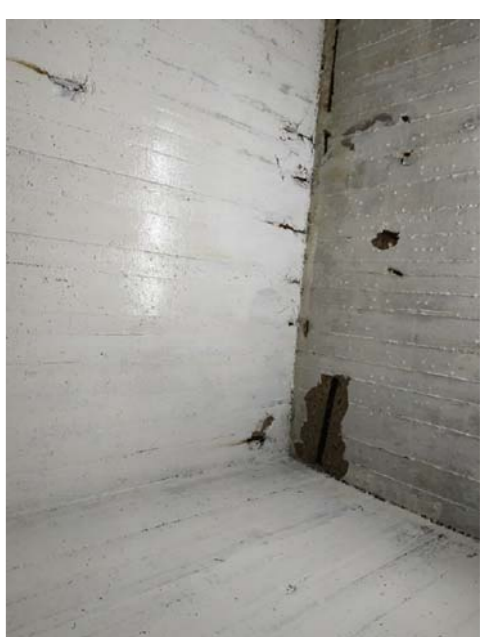
Particolare locale ripostiglio da risanare il dis armato
