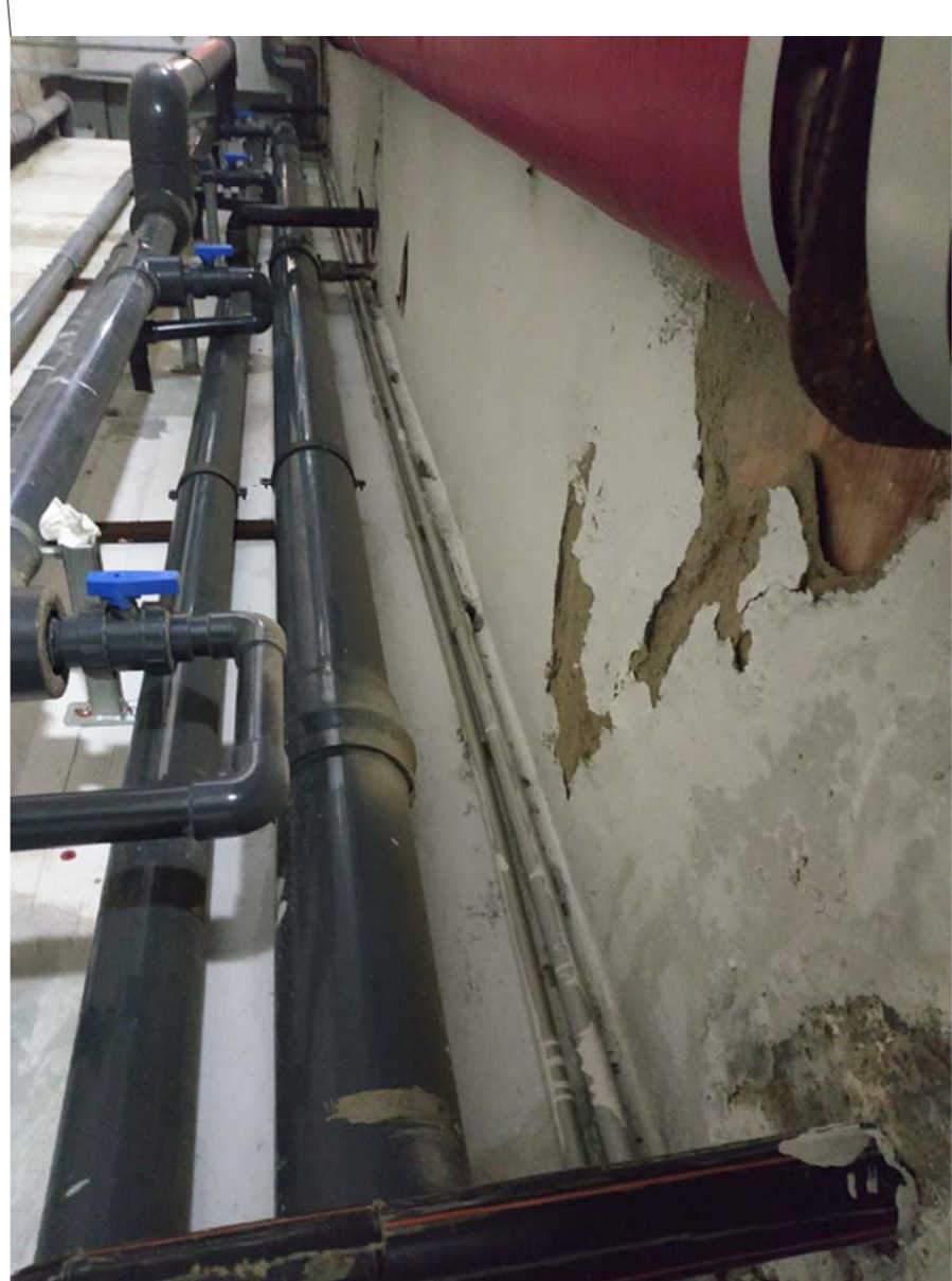
Solatio interrato tra il piano terra e interrato con principio di sfondellamento
