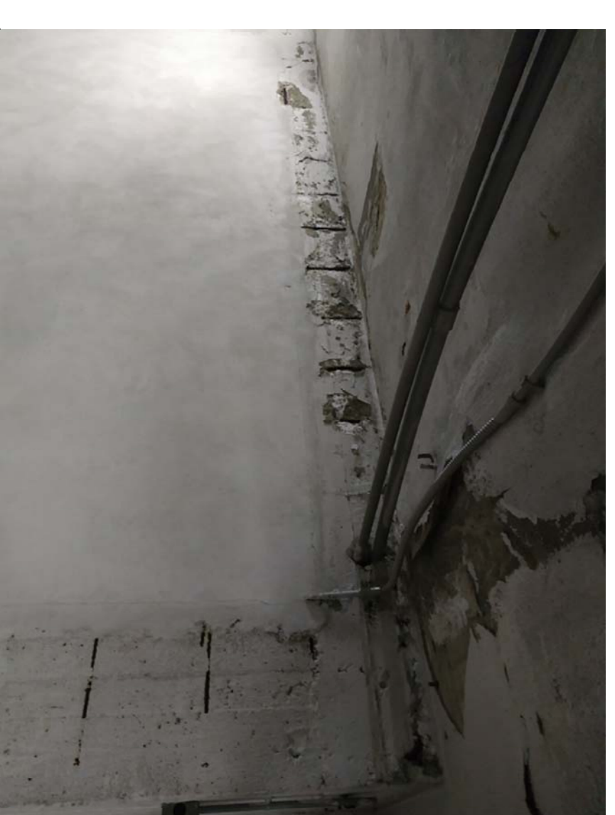
Solaio interposto tra il piano terra e interrato con porzione di ferri a vista e principio di stoncellamento del solaio
