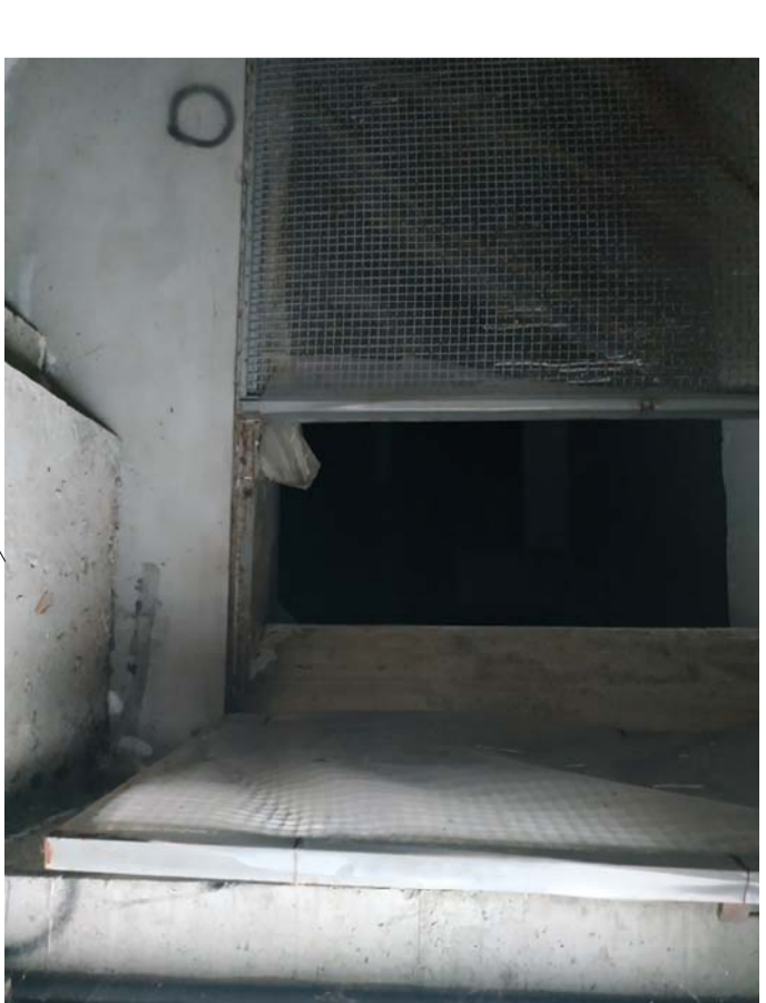
Accesso alla vasca di pompimento
