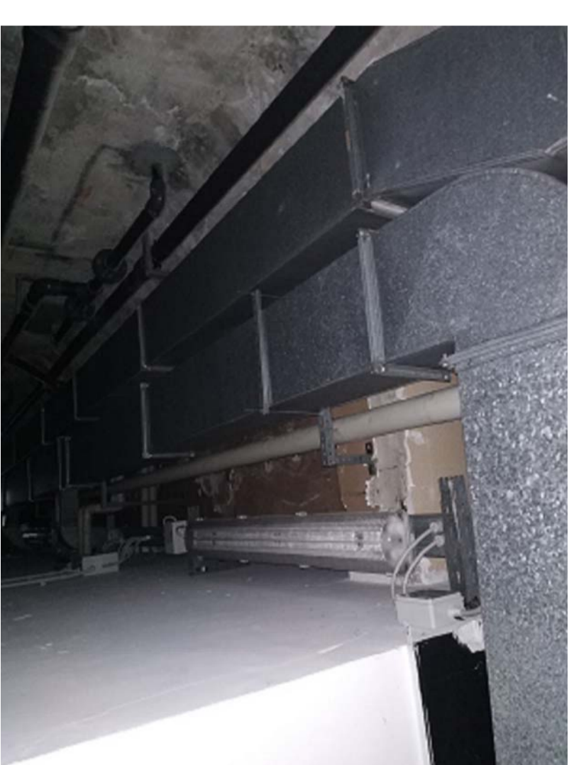
Impianti posti nel soffitto del piano interrato
