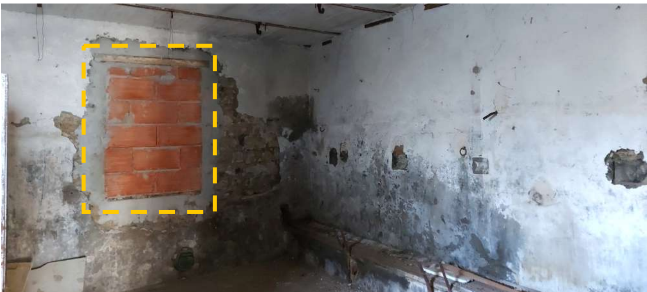
Apertura al piano terreno tamponata su entrambi i lati da riaprire (dim. 95 x 122 cm).
