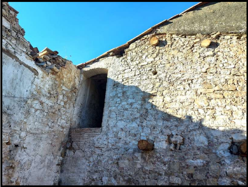
Foto n.11 – Accesso al Vano del piano primo (ex fienile). Vista delle orditure principali dei solai.
