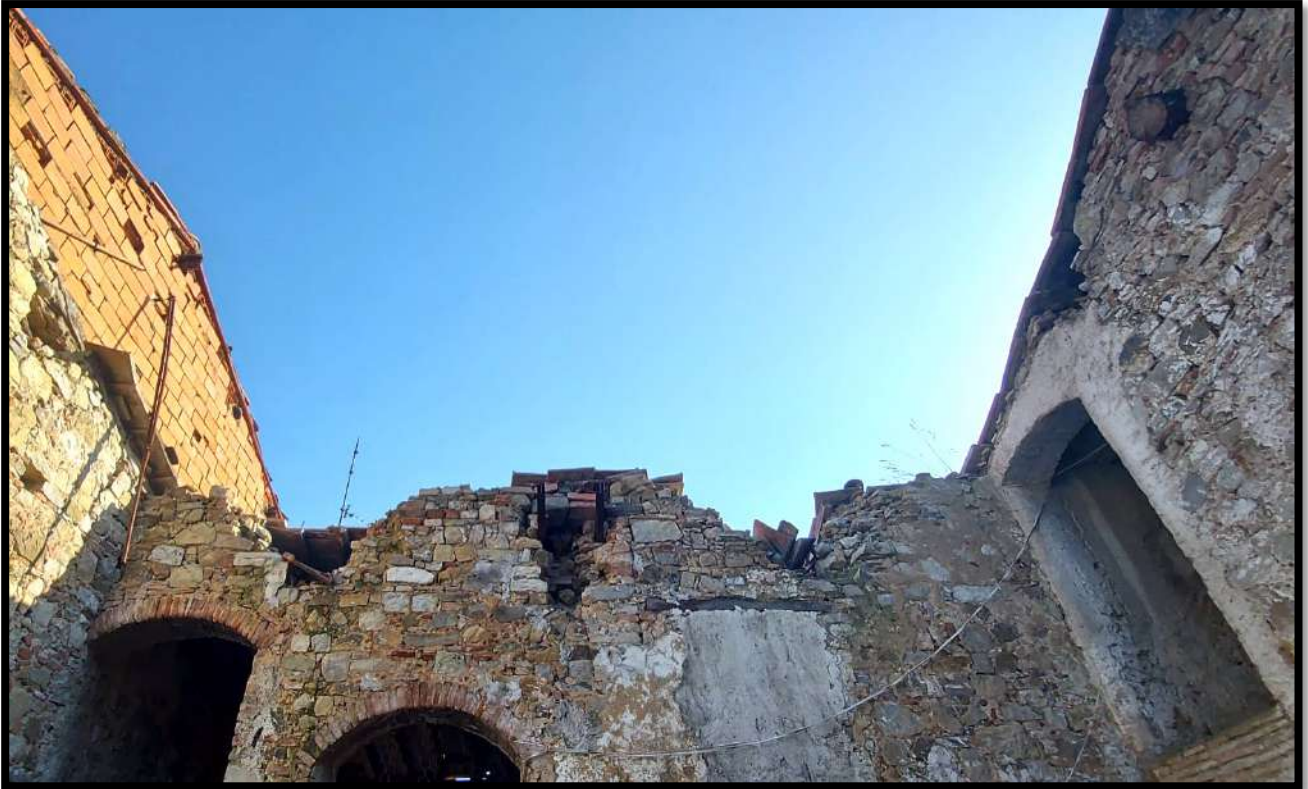
Foto n.13 – Vista delle porzioni crollate della copertura del magazzino (ex fienile).
