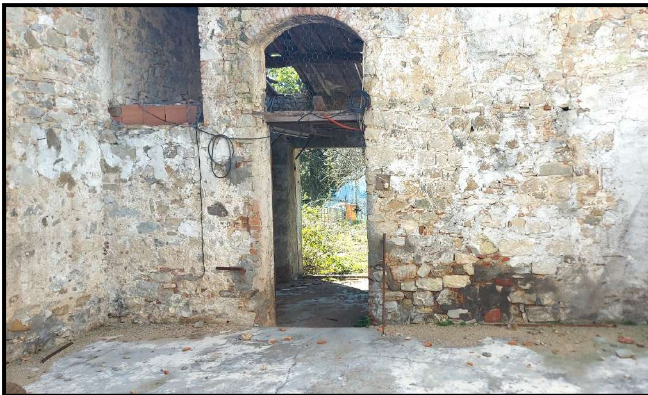
Foto n.10 – Magazzino (ex fienile), vista opposta alla Foto n.6. Vano in cui è crollato il solaio interpiano e la copertura del soprastante vano soffitta.
