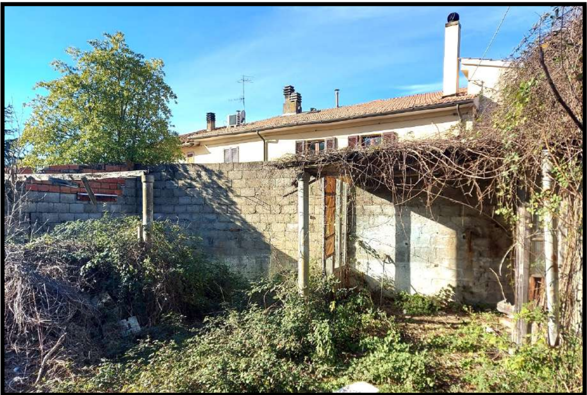
Foto n.4 – Loggia; visibile porzione di copertura crollata.
