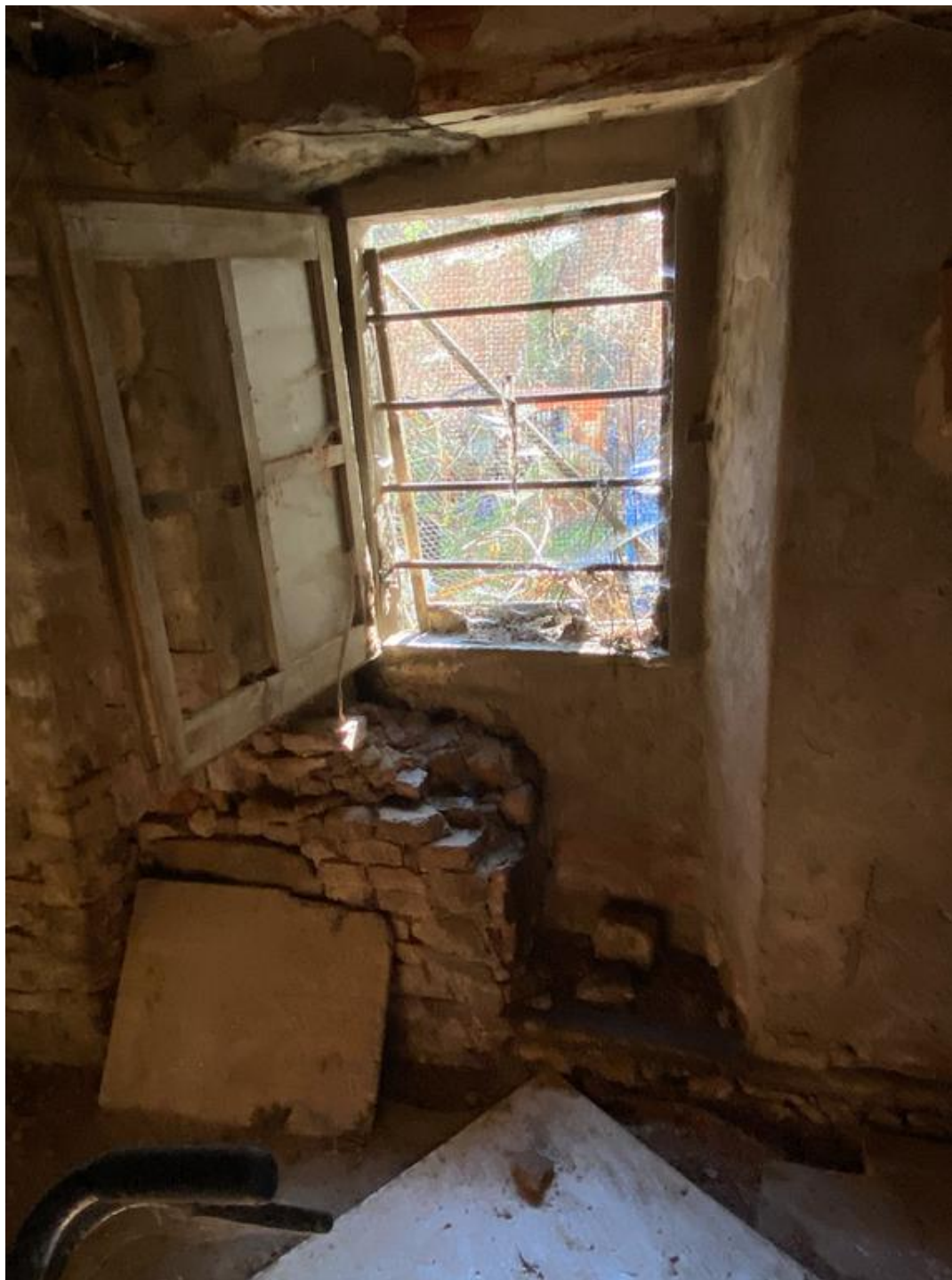
Porta trasformata in finestra, da riaprire
