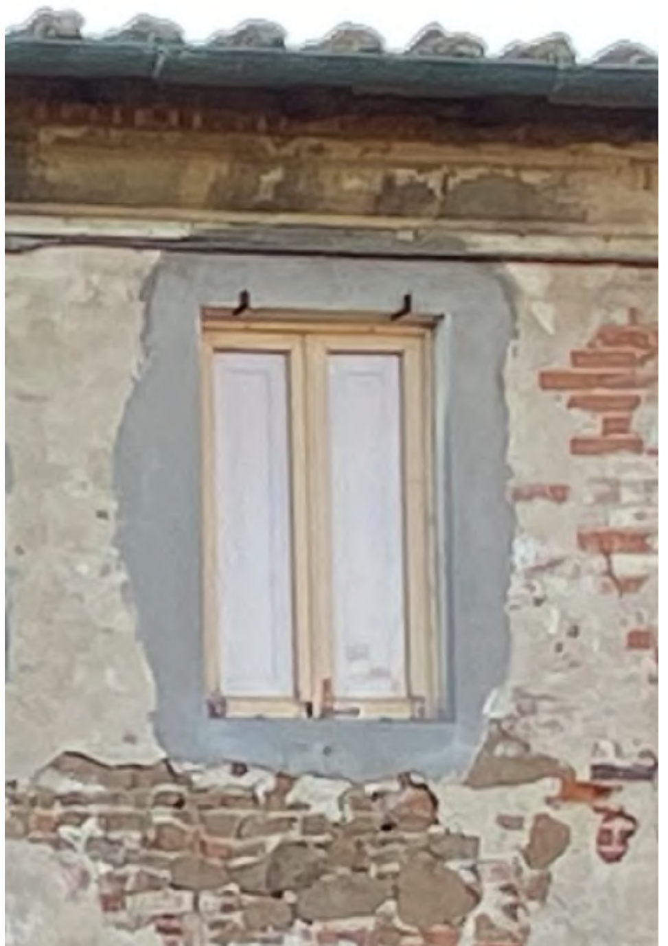
Apertura recente n°4. Da richiudere.
