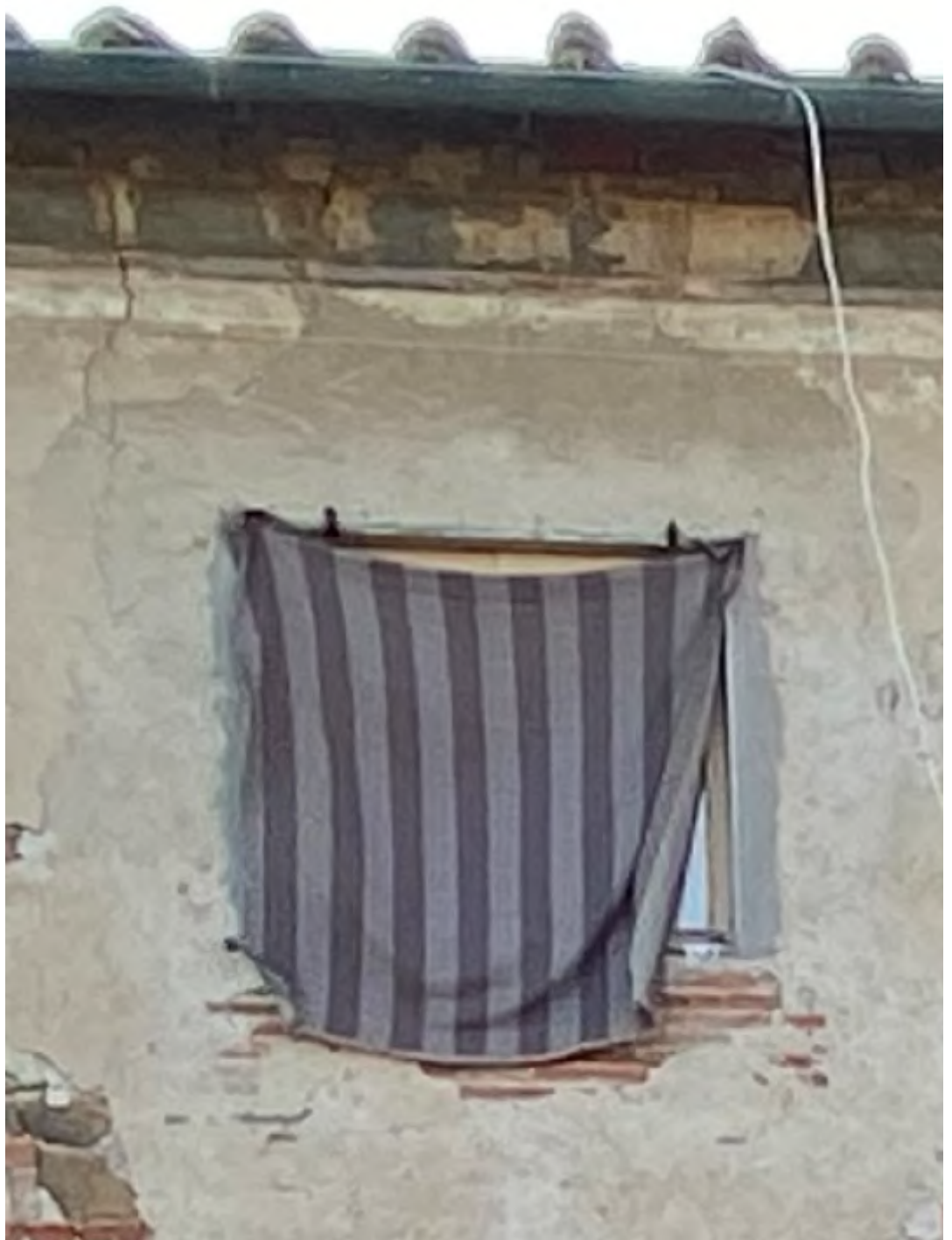
Apertura originaria deformata n°6. Da riportare alle misure originarie.
