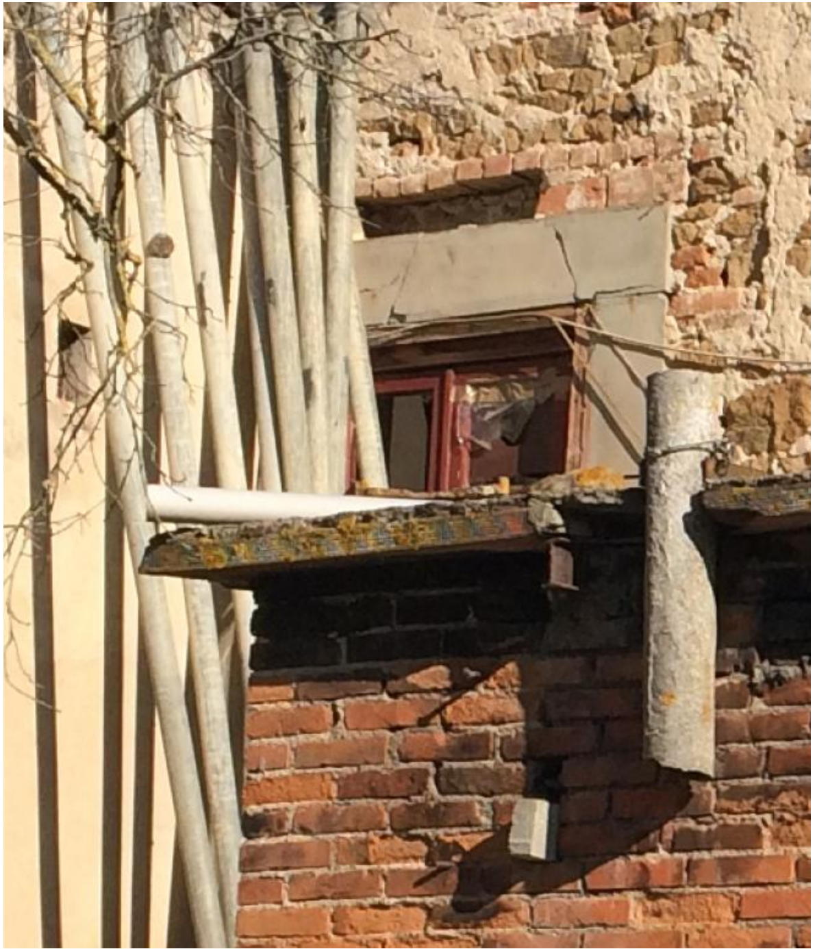
Finestra con cornice lapidea da recuperare
