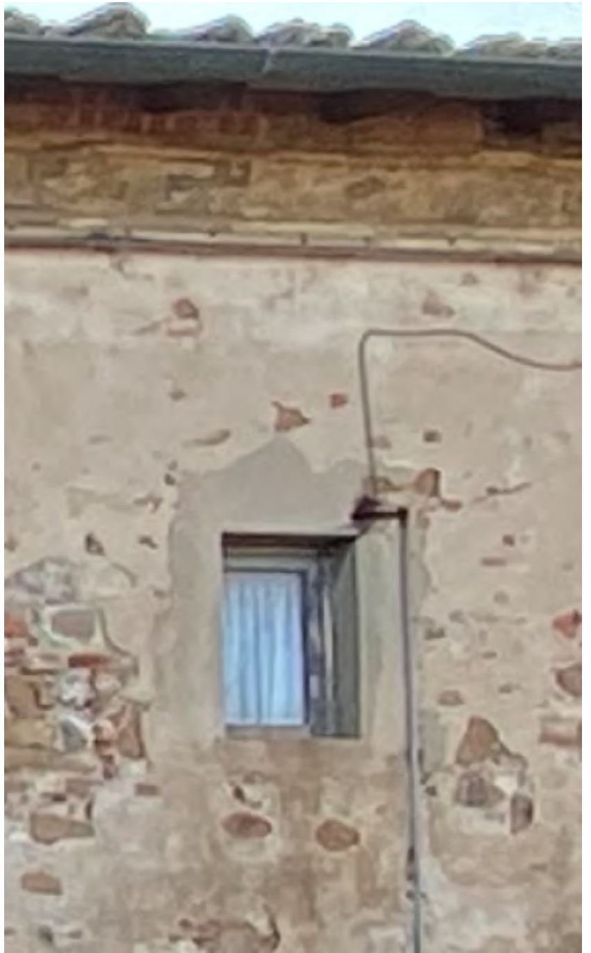
Apertura recente n°2. Da richiudere.
