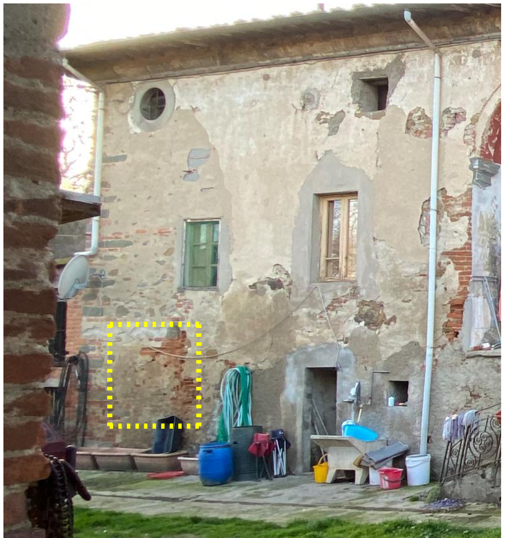
Tracce di finestra originaria richiusa. Da riaprire.
