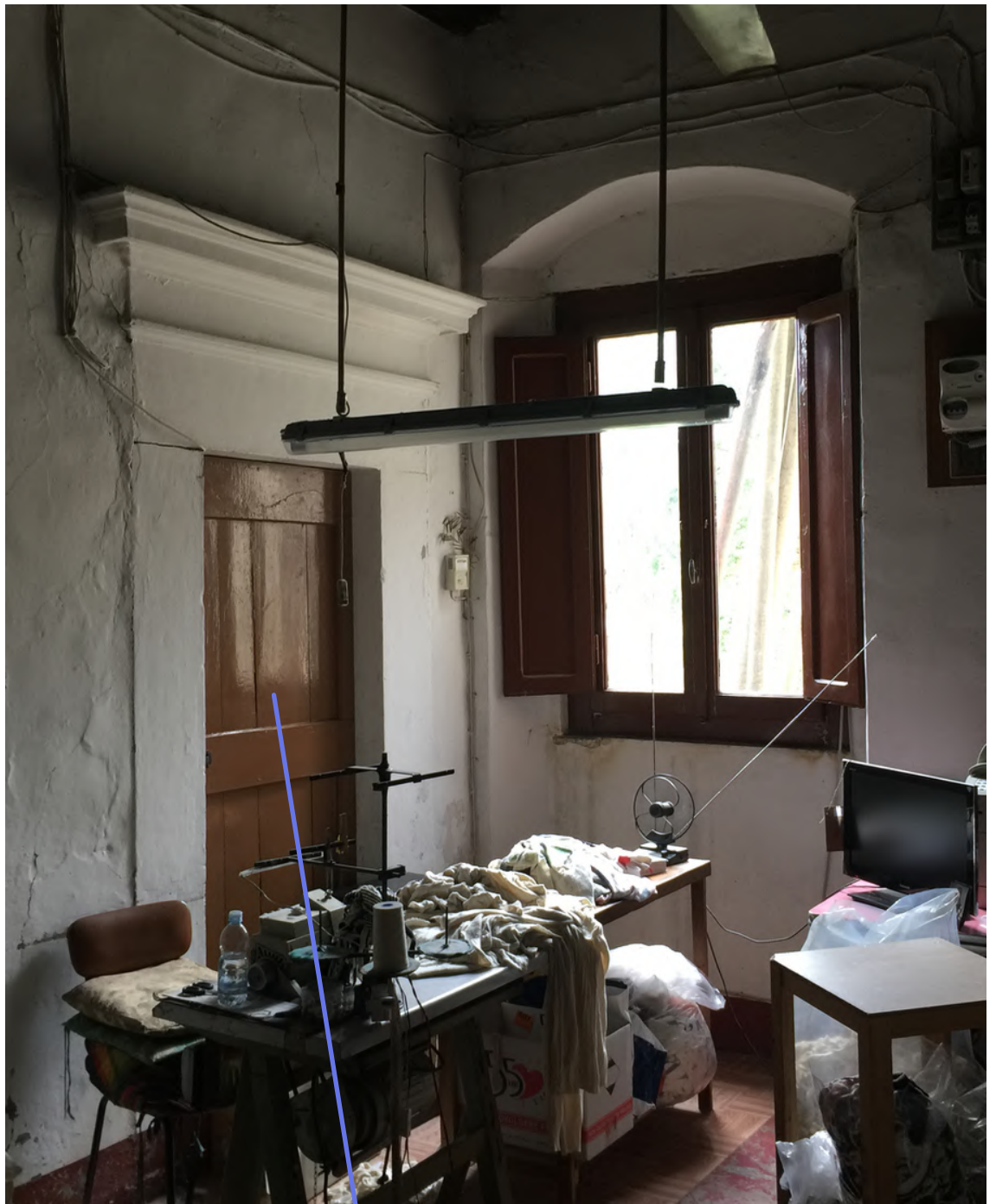
Portale interno con cornice lapidea da recuperare
