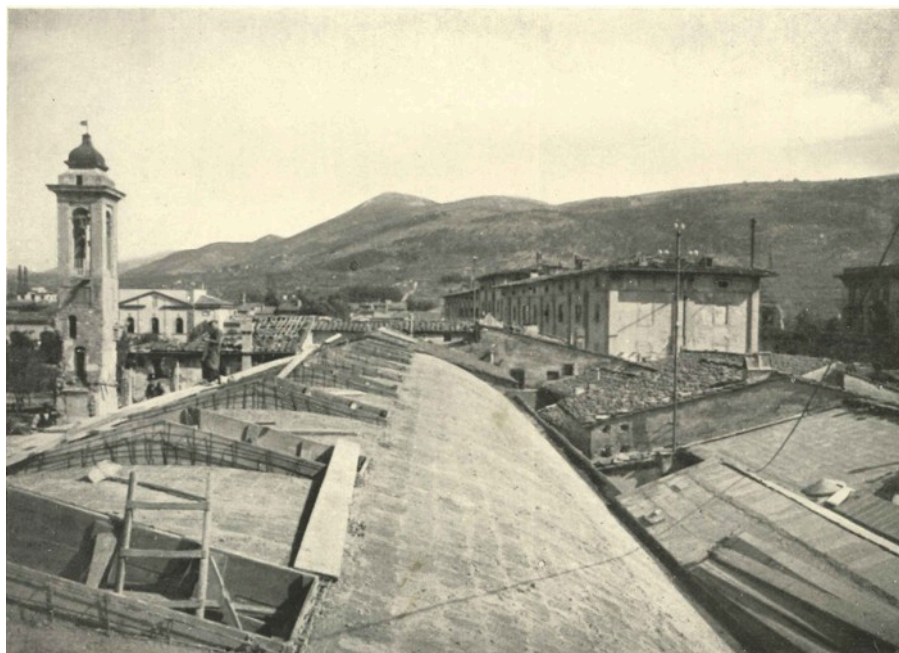
Fig.23. Lanificio Giovacchino Puggelli, via del Carmine, lavori di ripristino della copertura del salone di tessitura (Tamburini, 1945)
