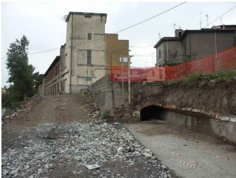
Gora sotterranea venuta alla luce durante i lavori di allargamento della S.R. 325
