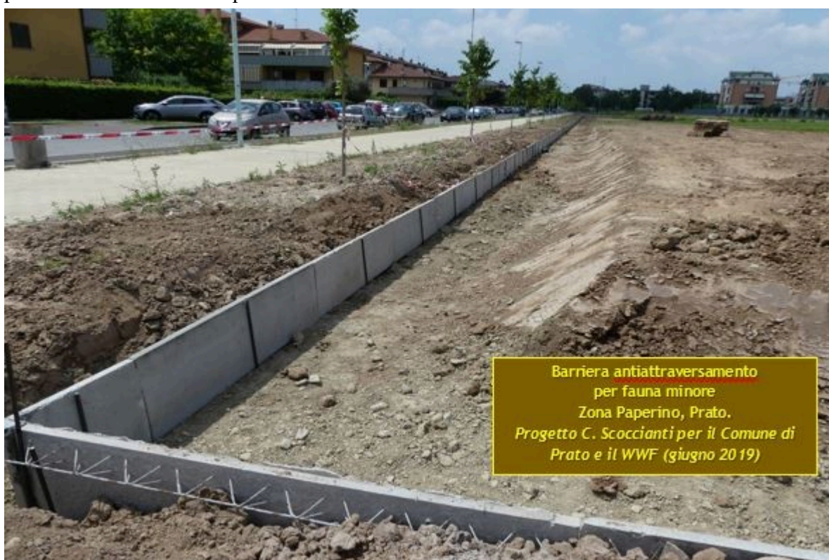
Figura 11 - Ultime fasi di costruzione di una barriera antiattraversamento per la tutela della fauna
