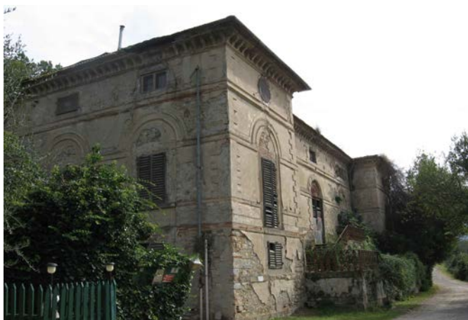
Esempio edificio (2° grado di tutela) in stato di abbandono
