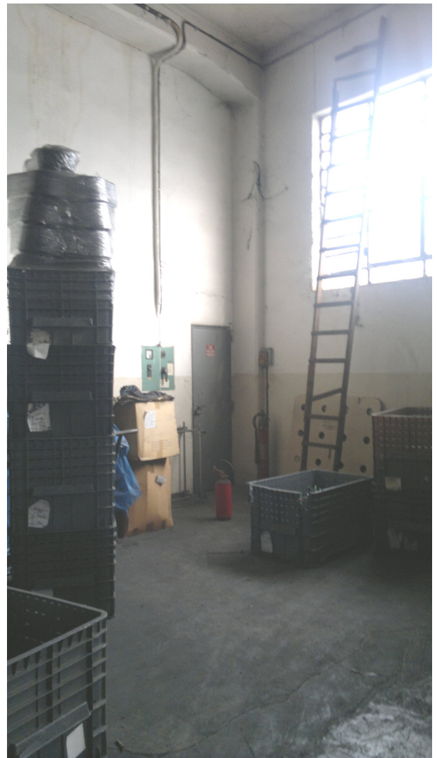
fronte strada filatura, ingresso alla cabina elettrica:
