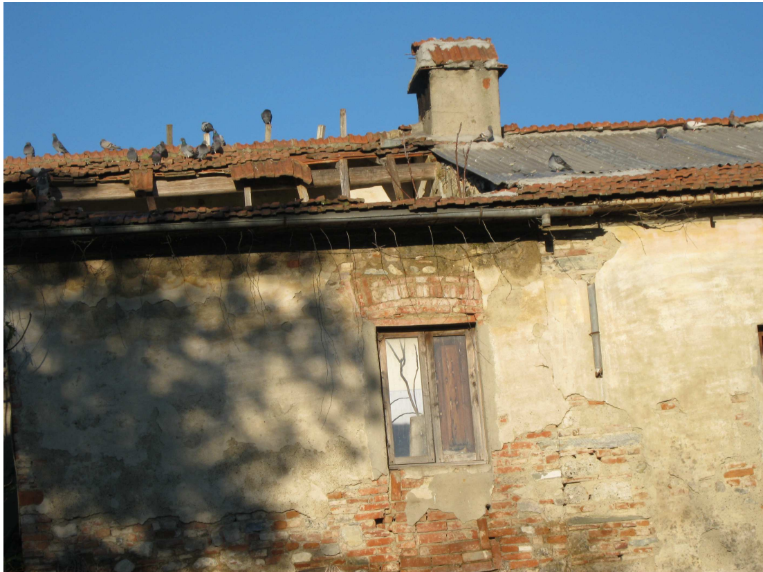
Foto 14 - Prospetto principale. Particolare di porzione di tetto crollato
