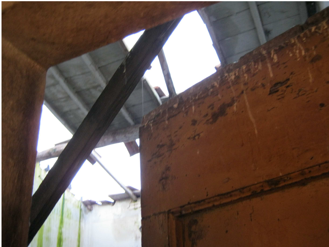
Foto 15 - Piano primo, particolare interno. Particolare di porzione di tetto crollato
