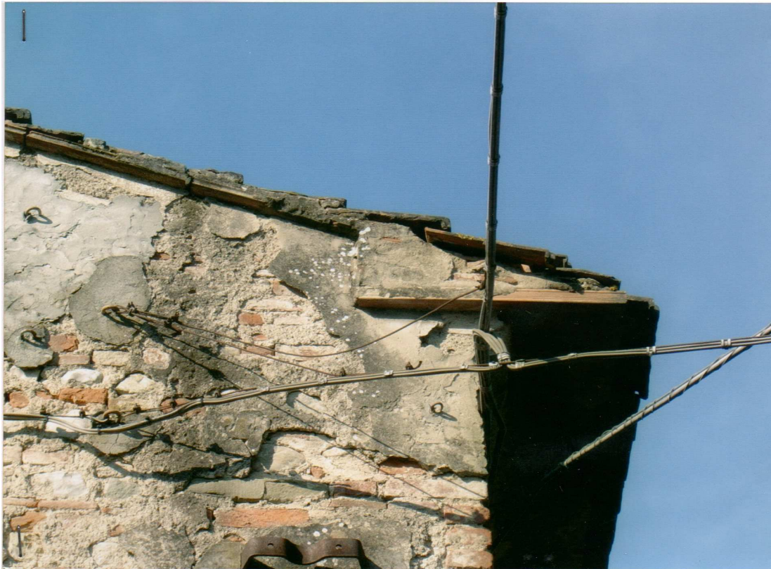
Foto 11 - Particolare del sottogronda privo di qualsiasi finitura, realizzato in tavelle intonacate.
