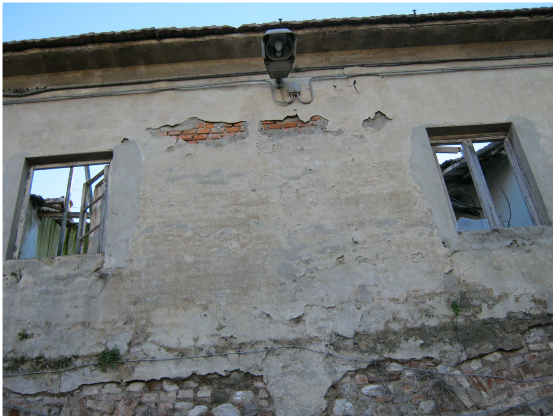
Foto 16 - Prospetto su Via dei Tini. Porzione di tetto crollato.
