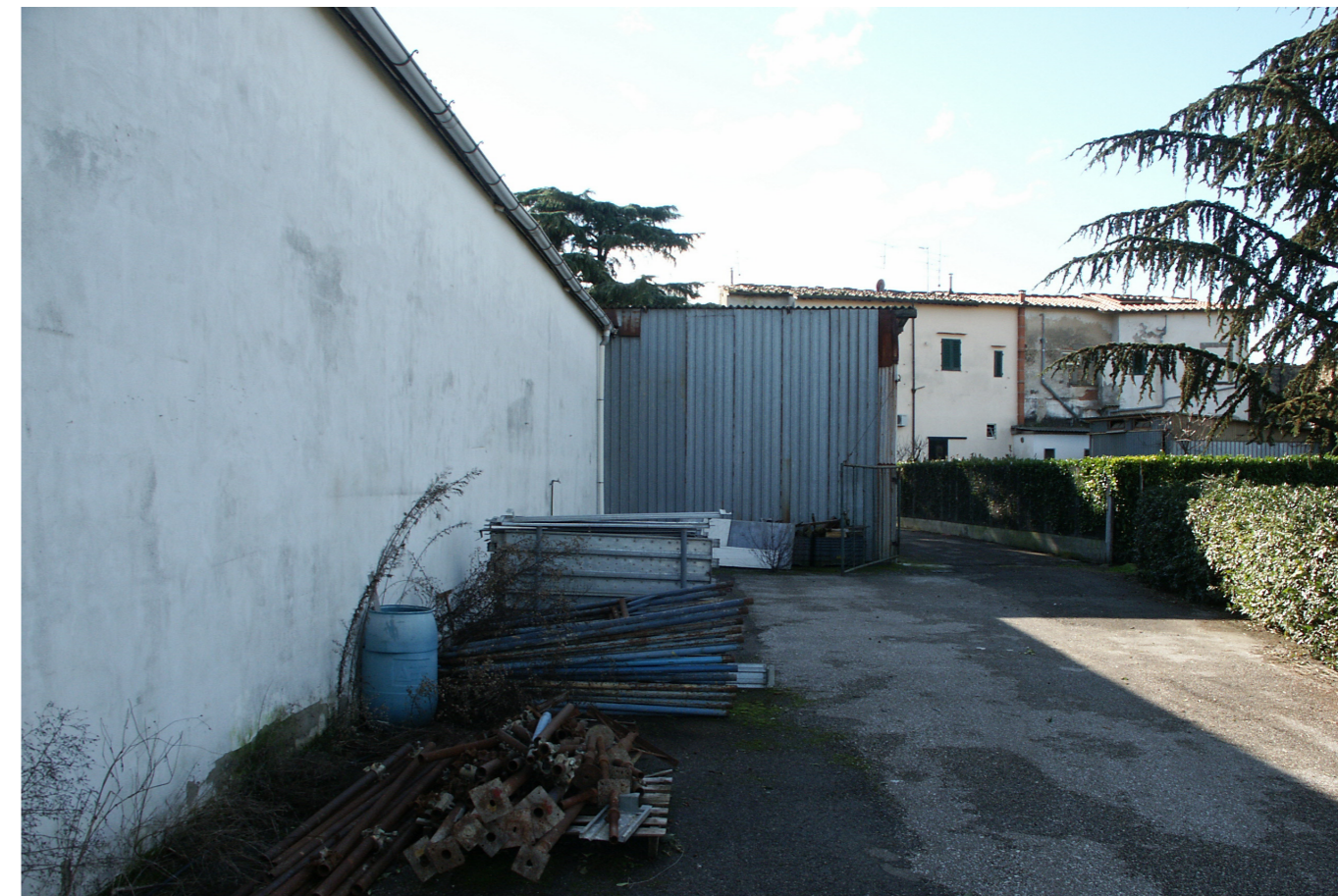
FOTO 10 - Degrado dei capannoni
