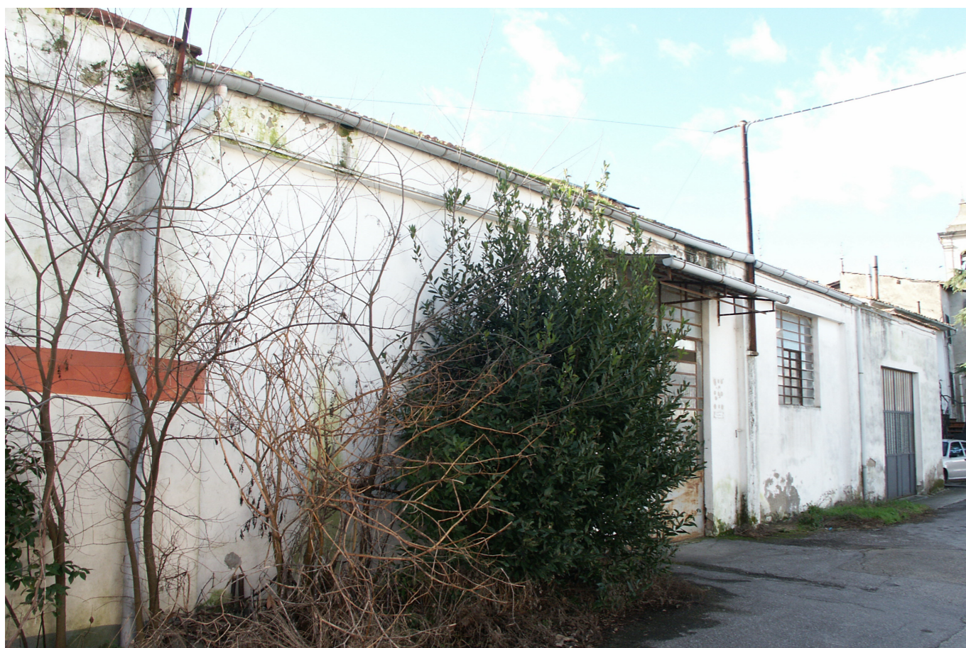
FOTO 3 - Degrado dei capannoni artigianali, lato nord-est
