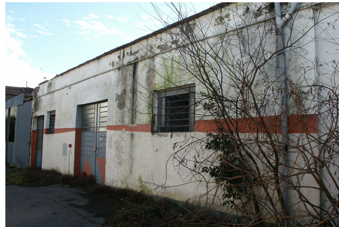
FOTO 4 - Degrado dei capannoni artigianali, lato nord-est
