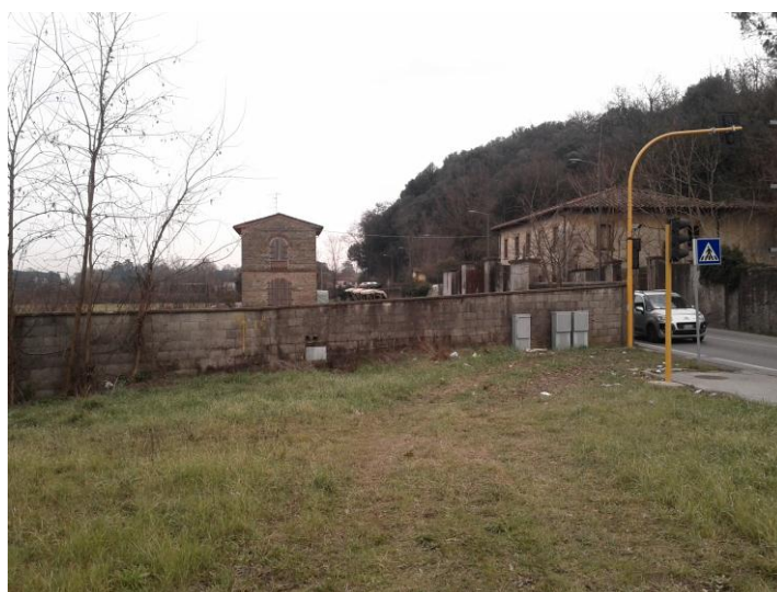
Centraline per la fornitura dell'energia elettrica in corrispondenza della statale 66.
